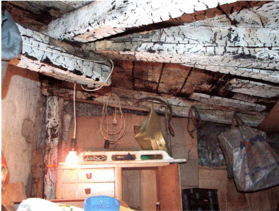
Fot. 23 – Uszkodzona konstrukcja i poszycie dachu na skutek pożaru.
