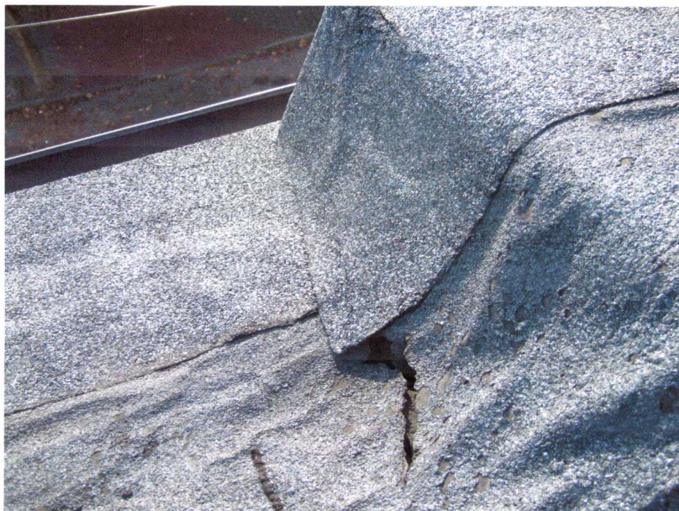
Fot. 10 – Pęknięta warstwa papy.
