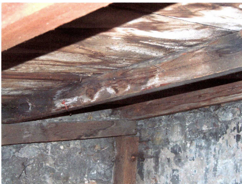
Fot. 19 – Zagrzybiona krokiew i poszycie dachu w części niespalonej.
