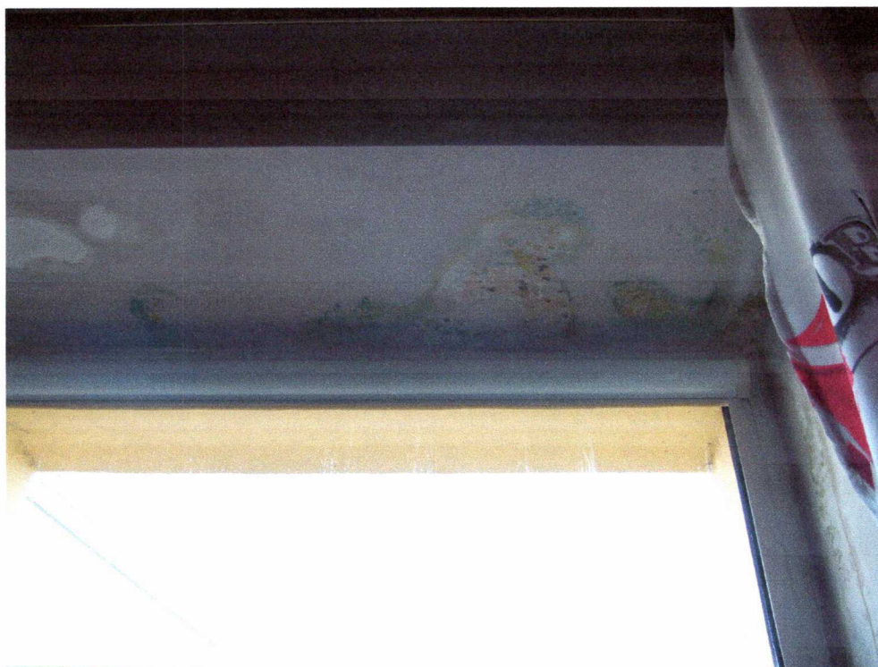
Fot. 5 – zaciek na nadprożu okiennym. Woda penetruje pod warstwę styropianu, świadczą o tym zacieki na zewnętrznej powierzchni szyby okiennej.
