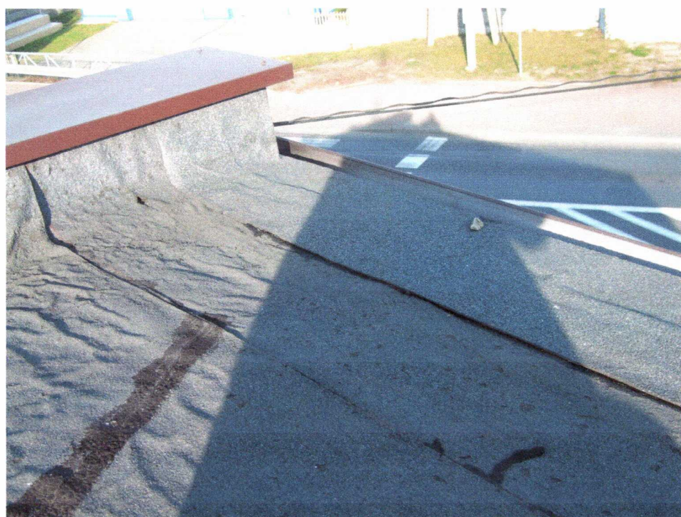
Fot. 6 – Pasek papy termozgrzewalnej niedokładnie zgrzany do podłoża.
