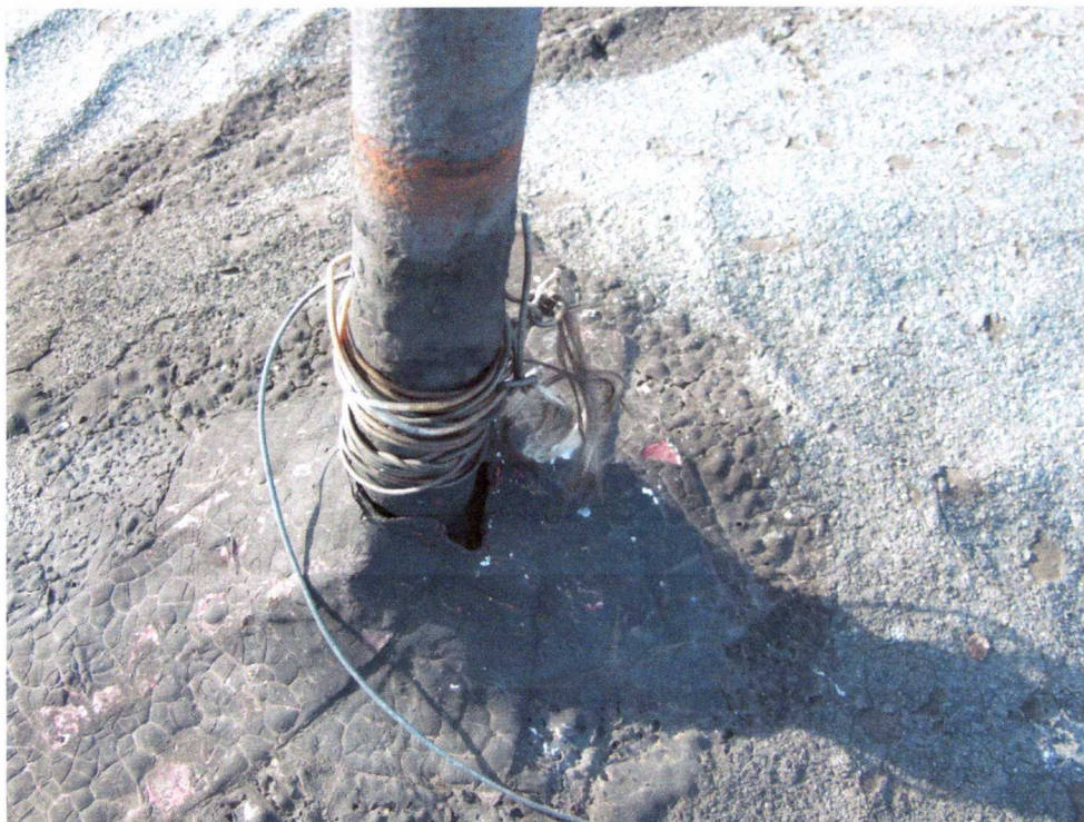
Fot. 11 – Nieszczelność pokrycia przy sztycy antenowej.
