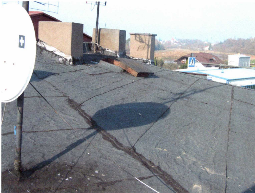
Fot. 13 – Brak obróbek i blacharskich i czapek kominowych
