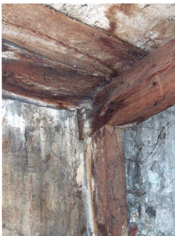
Fot. 20 – Zagrzybiona konstrukcja i poszycie dachu w części niespalonej.
