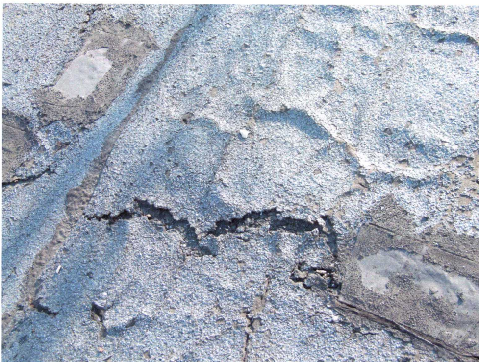
Fot. 9 – Pęknięta warstwa papy.
