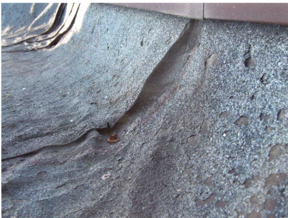
Fot. 7 – Odspojona od podłoża papa przy murku ogniowym.
