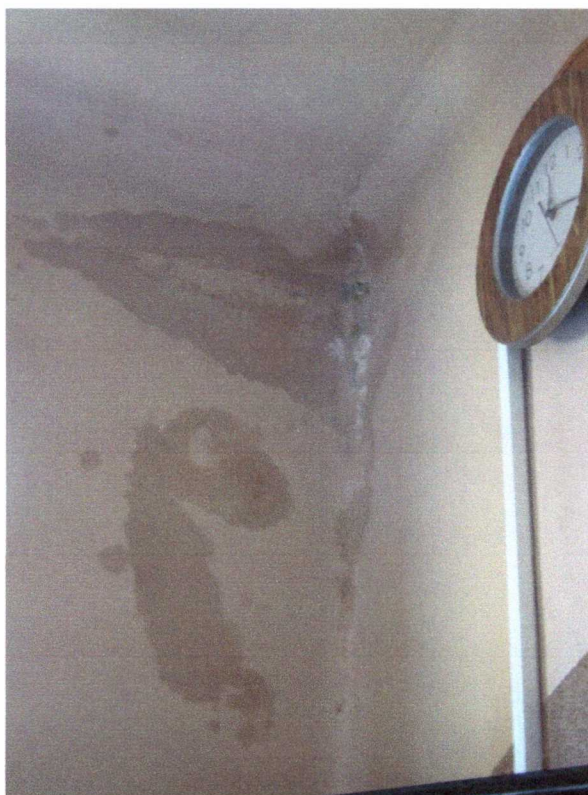
Fot. 4 – Zaciek wodny na stropie i ścianie w mieszkaniu nr 1.
