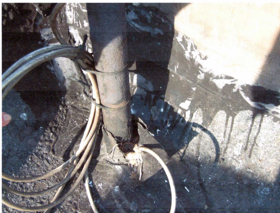
Fot. 12 – Nieszczelność pokrycia przy sztycy antenowej.
