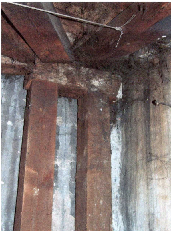
Fot. 17 – Zagrzybiona konstrukcja nośna dachu w części niespalonej.
