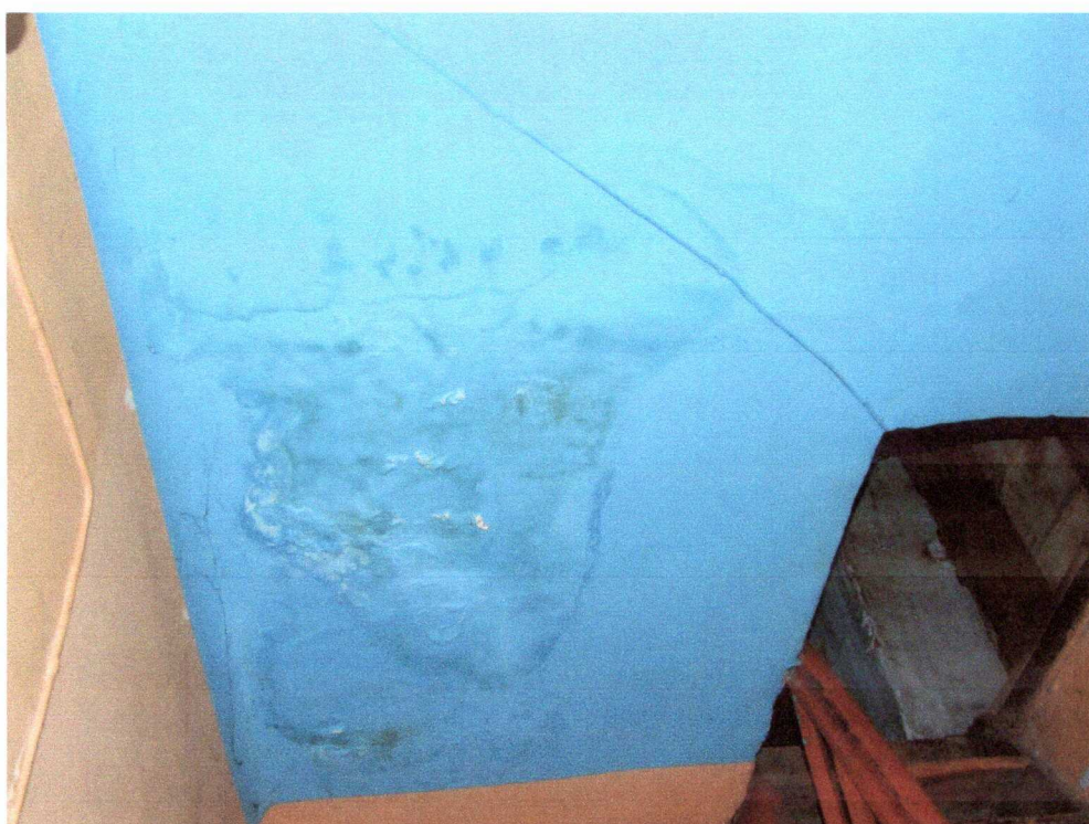
Fot. 2 – Zaciek wodny na stropie klatki schodowej budynku.
