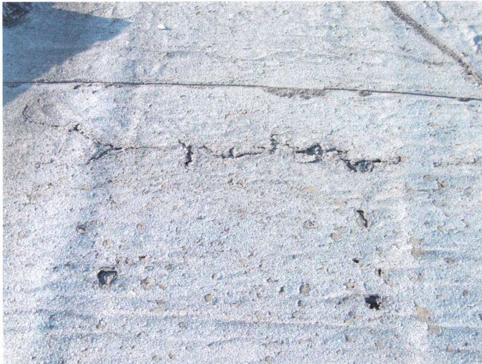
Fot. 15 – Rozszczelnienie pokrycia z papy.
