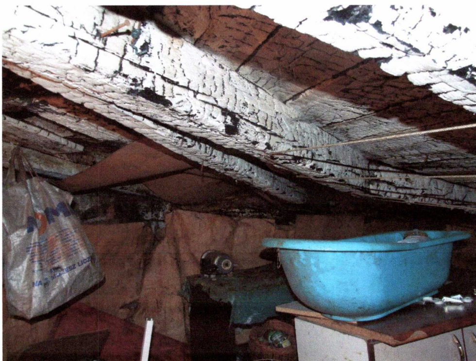
Fot. 21 – Uszkodzona konstrukcja i poszycie dachu na skutek pożaru.
