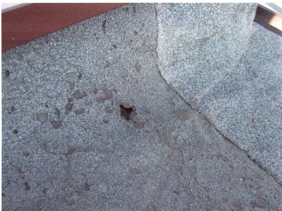
Fot. 8 – Dziurawe pokrycie przy murku ogniowym.
