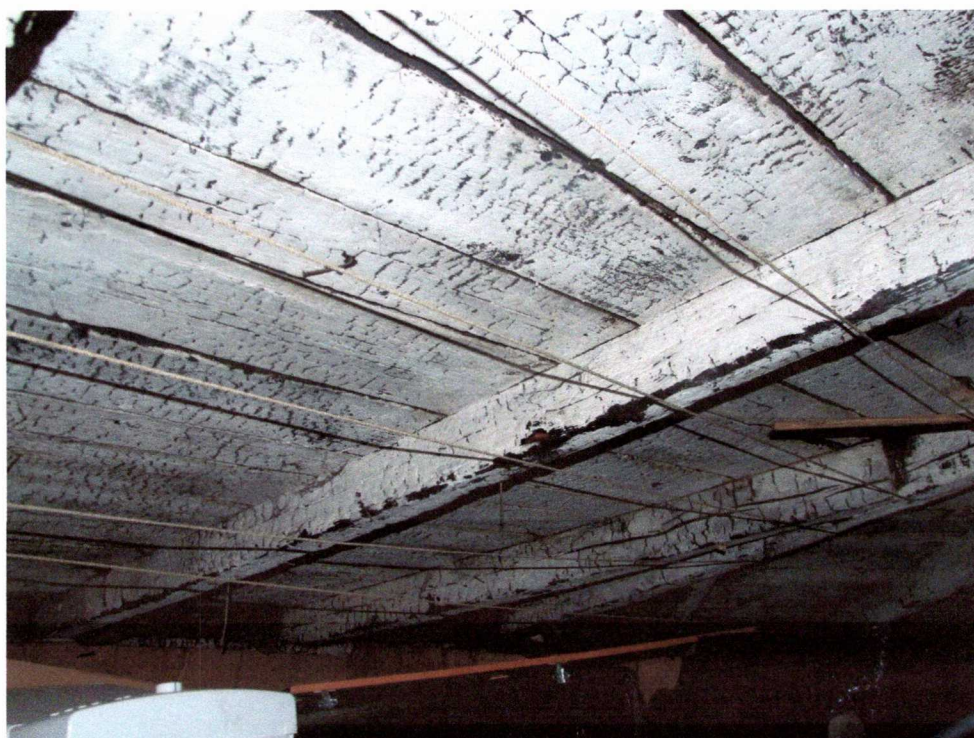
Fot. 22 – Uszkodzona konstrukcja i poszycie dachu na skutek pożaru.
