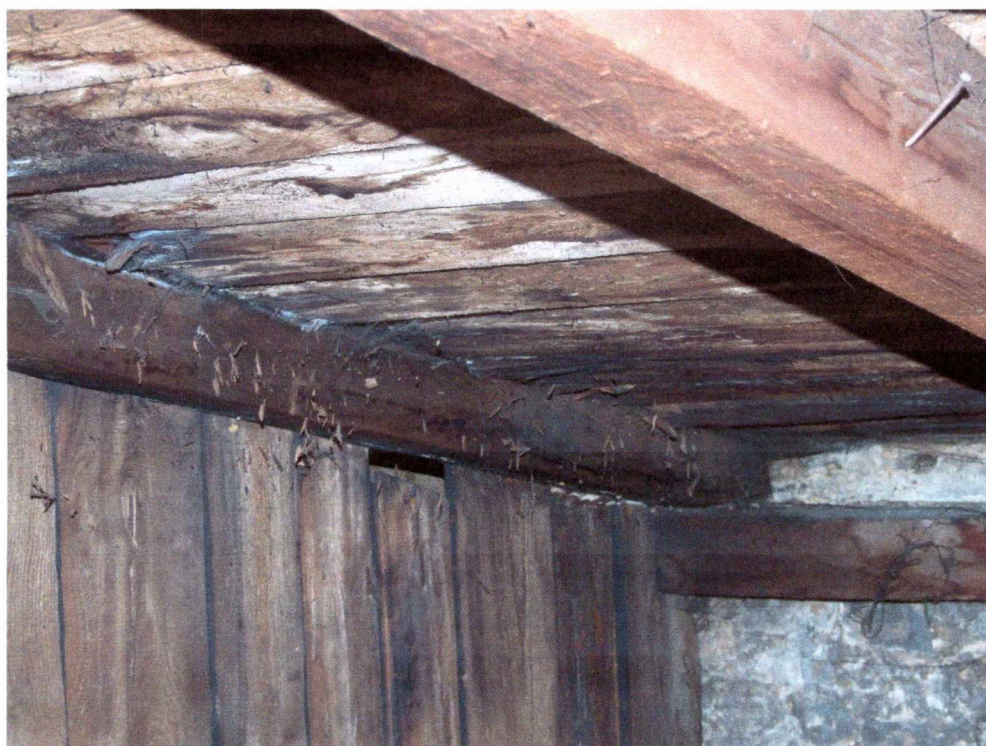
Fot. 18 – Zagrzybione poszycie dachu z desek w części niespalonej.
