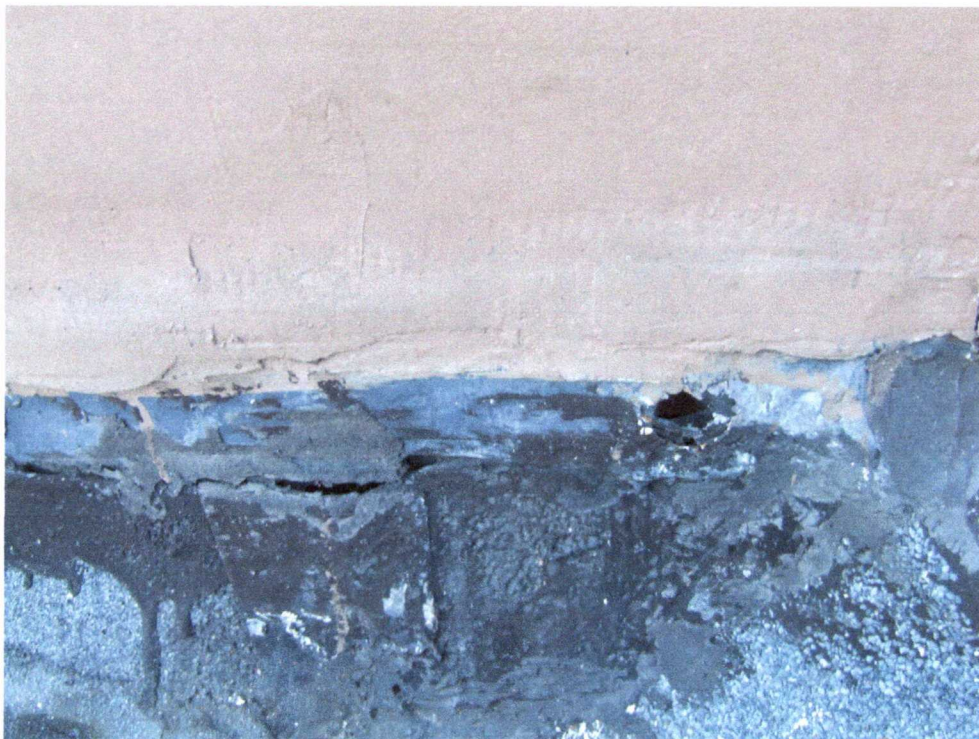
Fot. 14 – Rozszczelnienie pokrycia przy kominie. Brak obróbki blacharskiej.
